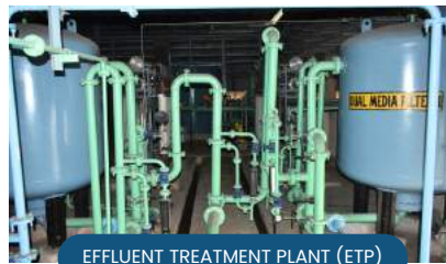
EFFLUENT TREATMENT PLANT (ETP)
